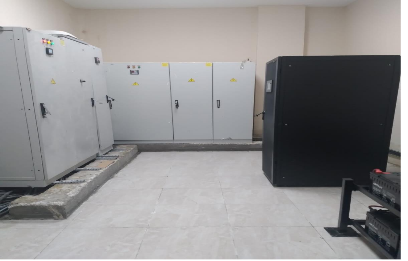
(100 KVA Kesintisiz Güç Kaynağı)
