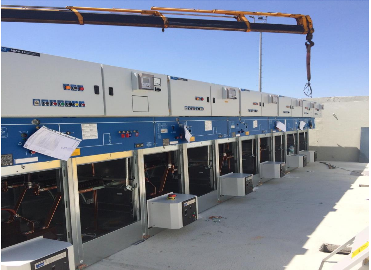
(Spor Fakültesi Trafo Merkezi ve Jeneratör)
